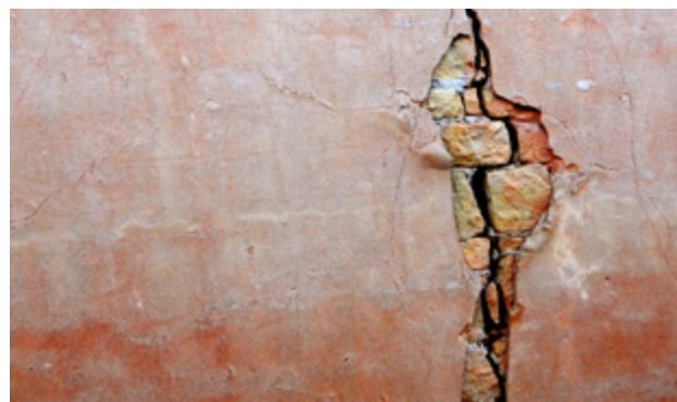
Un muro fracturado
